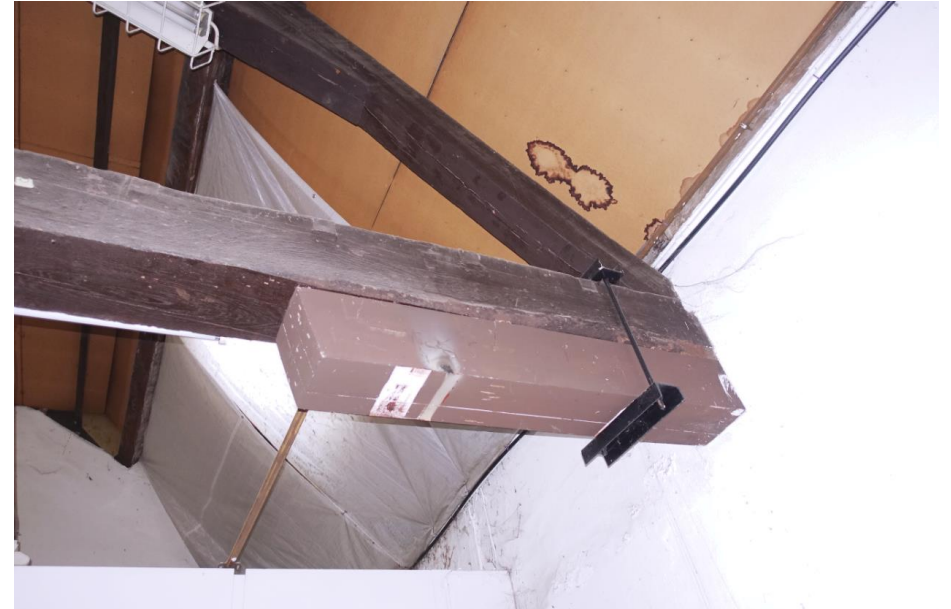
Detail van een later aangebrachte houten slof die onder de onderste dekbalk is geplaatst.
