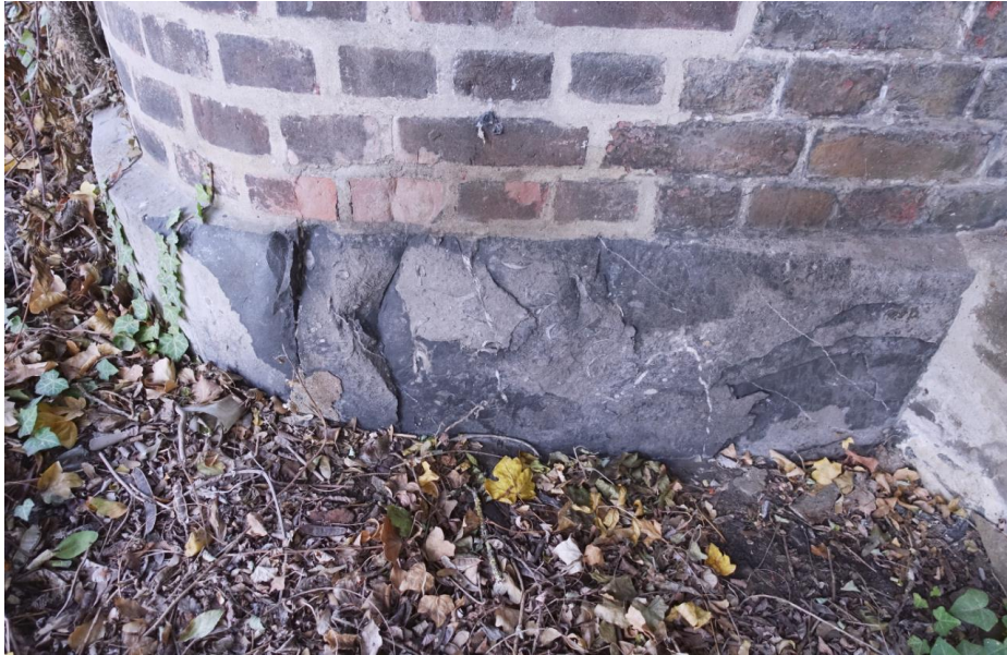
Detail van de hardstenen plint waarop de pijlers zijn gebouwd, zoals hier aan de oostzijde.
