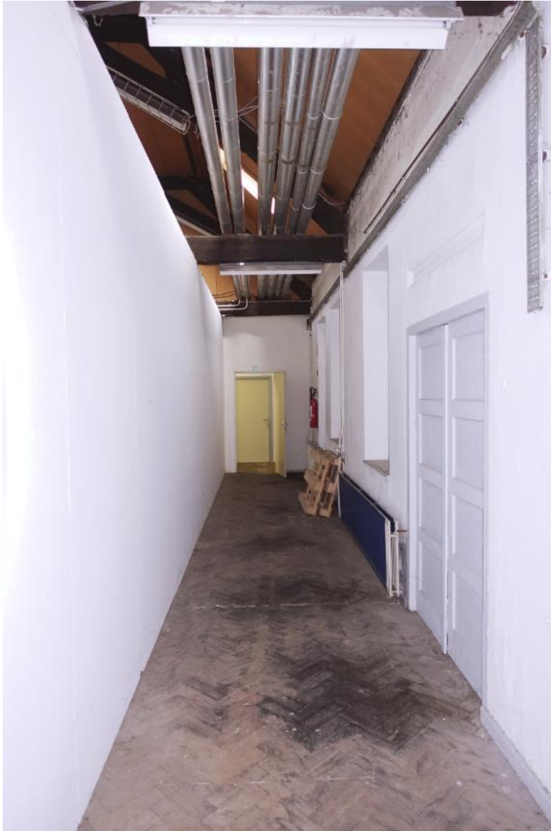
De gang tegen de oostgevel die het schildersatelier met de berging van de carnavalsvereniging verbindt.
