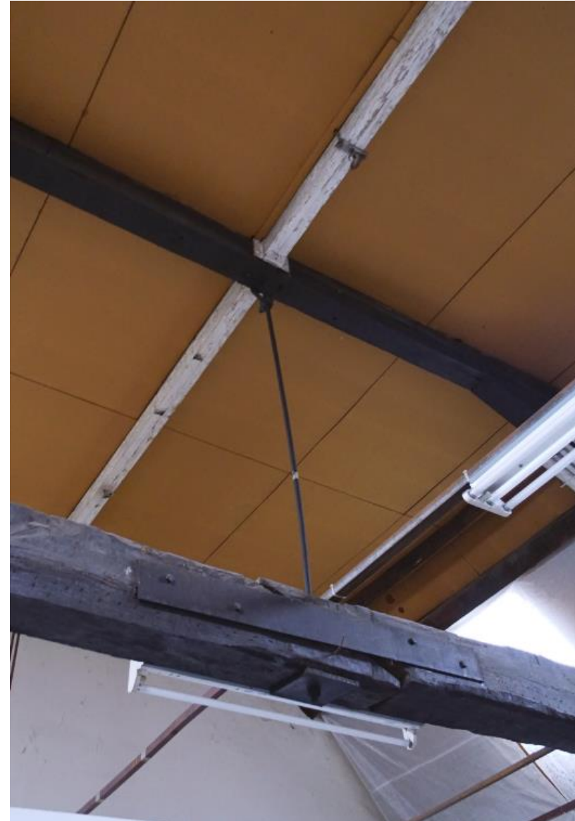
Detail van een ijzeren anker tussen hanenbalk en debalk die de twee losse debalken van de kapconstructie bij elkaar houdt.
