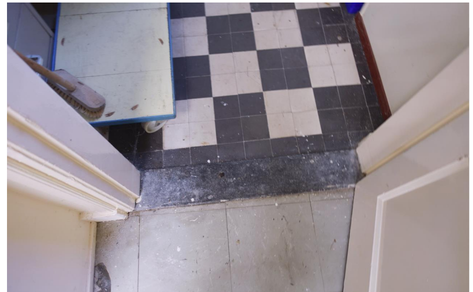
Zicht op de jongere tegelvloer in de repetitieruimte en de vloer in blokpatroon uit 1940 in de naastgelegen vestibule.
