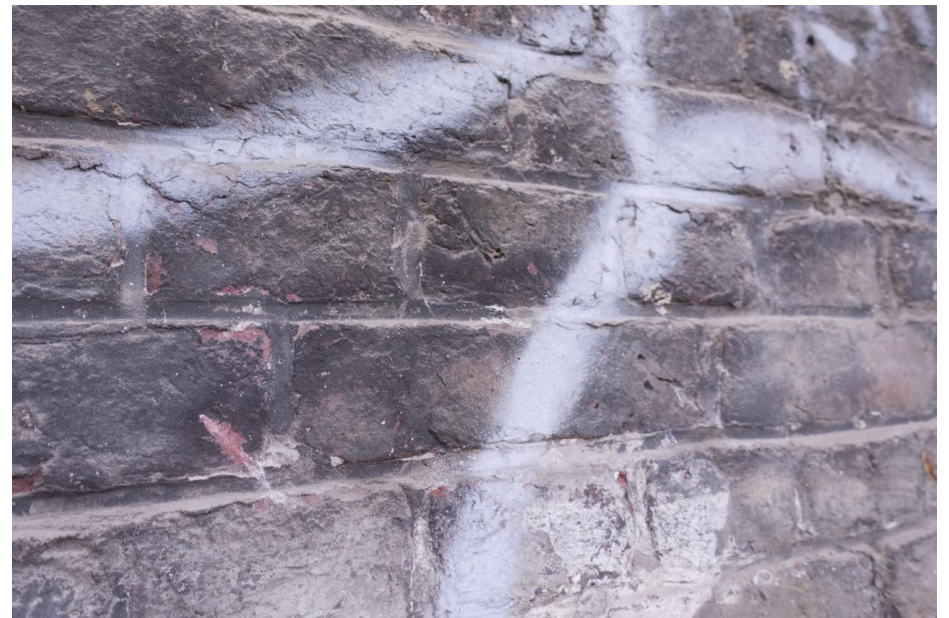
Detail van het metselwerk met voegwerk uit 1876 in de vulling van de boog aan de oostzijde.
